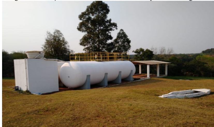
Fotografia 2 - Estação de tratamento de efluentes campus Cerro Largo
