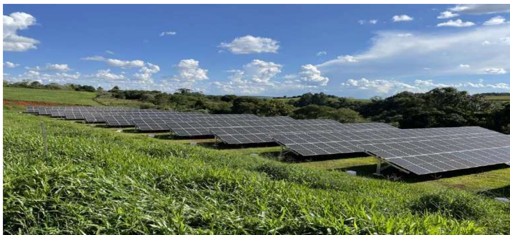
Figura 67- Usina fotovoltaica da Universidade Federal da Fronteira Sul (UFFS) – Campus Erechim em 2021
