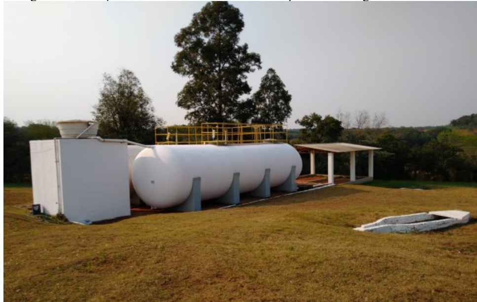
Fotografia 2 - Estação de tratamento de efluentes campus Cerro Largo
