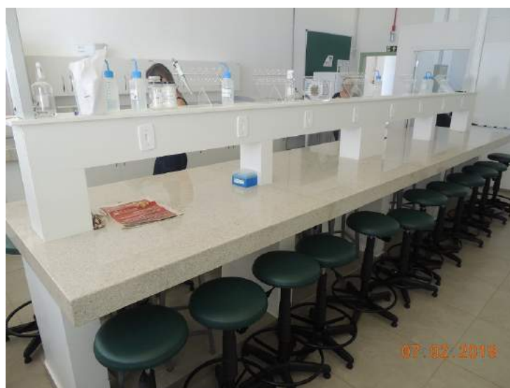
Figura 26 – Bancada com altura inadequada ao uso PcD nos Laboratórios Didáticos do Campus Cerro Largo
