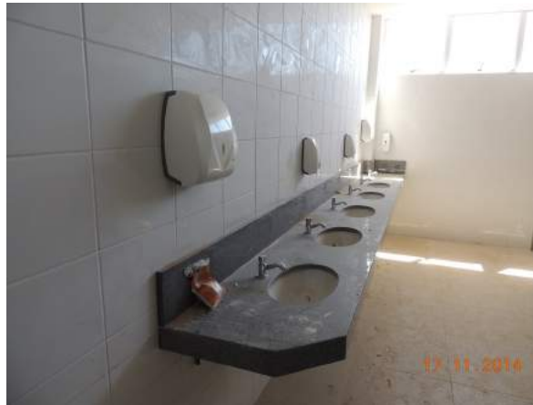
Figura 17– Bancada de lavatórios sem unidade rebaixada no Campus Erechim
