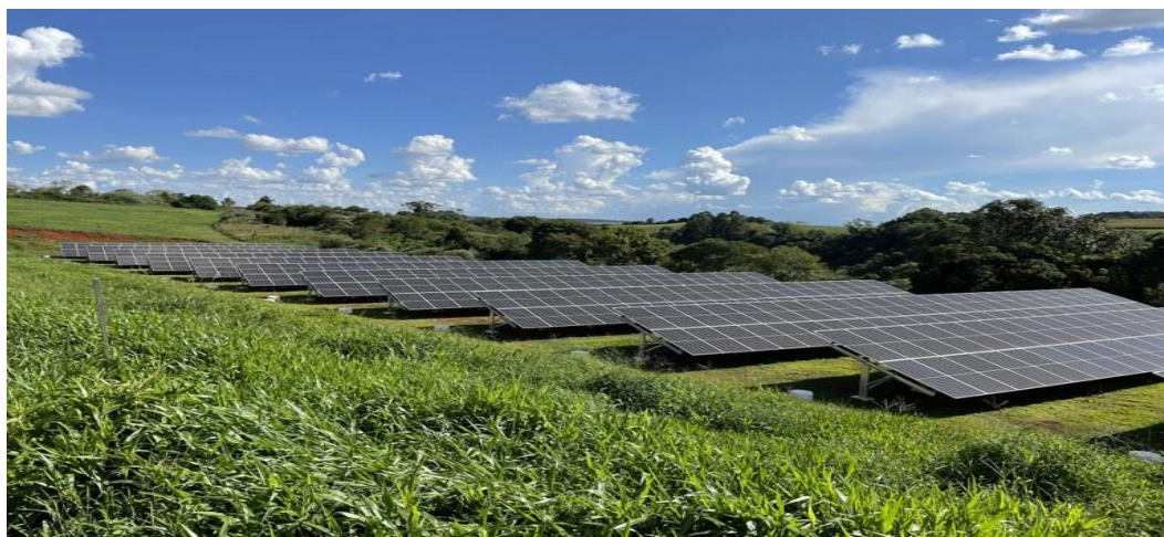
Figura 67- Usina fotovoltaica da Universidade Federal da Fronteira Sul (UFFS) – Campus Erechim em 2021
