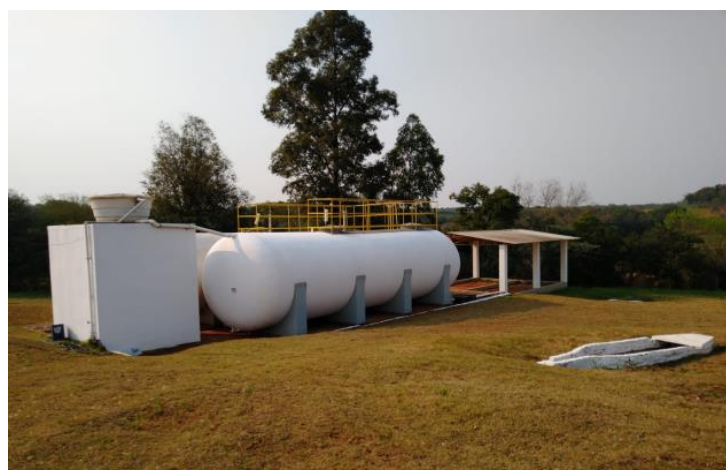
Figura 25 – Estação de tratamento de efluentes campus Cerro Largo Fonte: DGA/PROAD/UFFS, 2021
